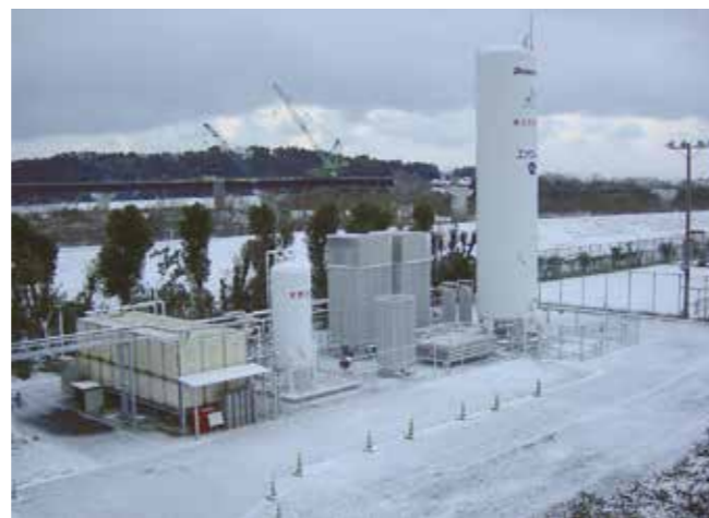
LNG Satellite Overview
