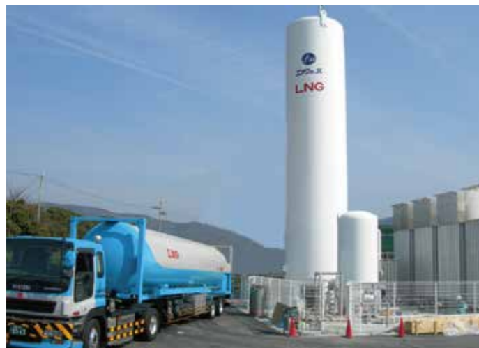
LNG Satellite Station
